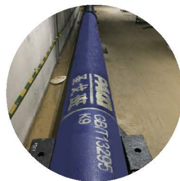
河南省郑州市中心城区地下综合管廊工程 惠济花园口镇、金水科教园区和马寨新镇区综合管廊 再生水工程 DN150-DN400 16公里 再生水管道
