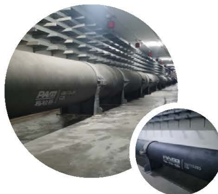
湖南省长沙市湘江新区月季路(枫林路—黄桥大道) 道路及综合管廊工程 DN600-DN1000 3.7公里球墨铸铁供水管道
