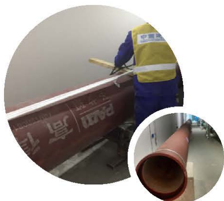
陕西省西安地下综合管廊 常宁新区项目示例单元 DN500 排水管道
