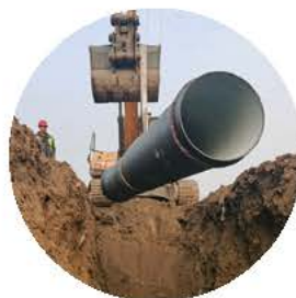
山西省灵石县纯净污水处理有限公司 再生水收集输送管网工程(全内自锚管线) DN150-DN800 65公里
