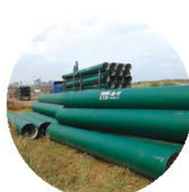
海口市美安科技新城高新区 供水管网工程(A、B、C区) DN100-DN800 100公里
